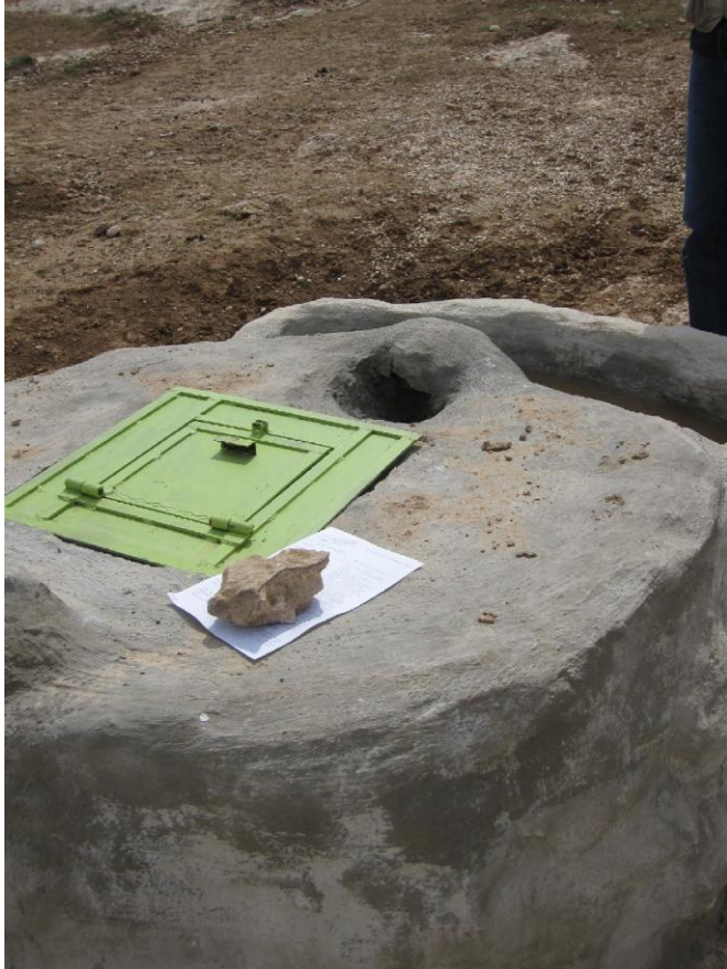
Demolition Order auf einer Zisterne im Dorf Al Fakheit
